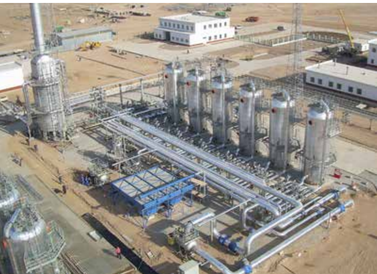
Строительство установки осушки газа КС «Багтыярлык» газопровода «Малай – Багтыярлык», Туркмения Источник: «УралХимМаш»
