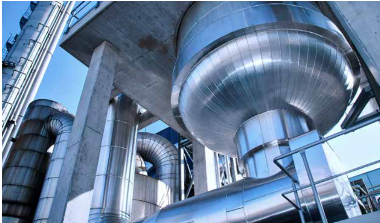
Установка по производству водорода
