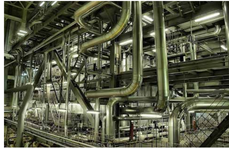
Котел-утилизатор Источник: kotlotech.ru
