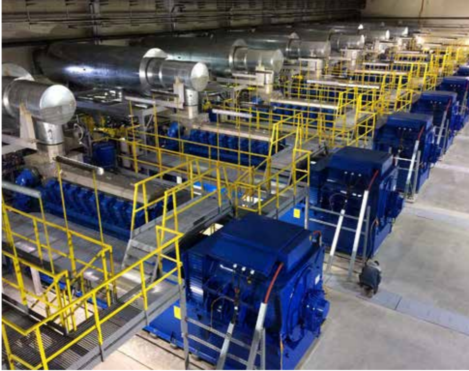
Газопоршневая электростанция Источник: «Ролт Инжиниринг»
